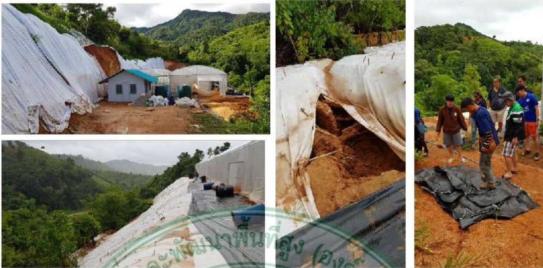
ภาพที่ 4.43 ลักษณะการแตกร้าวและรอยการกัดเซาะบริเวณลาดดินถม พื้นที่โรงเรียน โครงการฯ แม่สอง และการสาธิตการใช้กระสอบมีปีก
