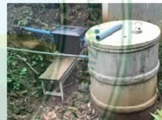
ถังดักไขมันและบ่อกรอง
