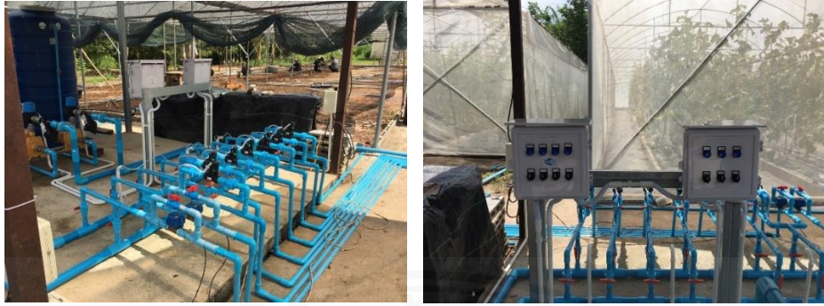
ภาพที่ 11 ระบบอัตโนมัติในการจัดการน้ำและปุ๋ย พร้อมระบบเซนเซอร์ตรวจวัดต่างๆ ในการทดสอบปลูกเมลอน พื้นที่ห้วยเป่า
