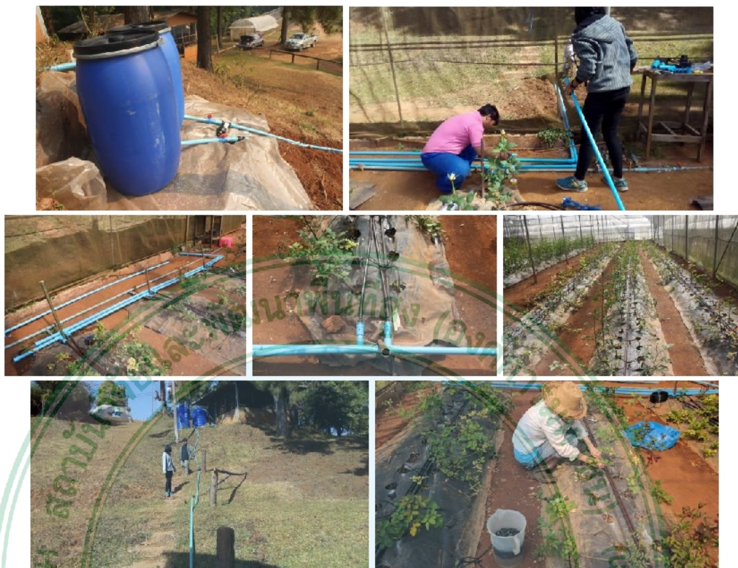
ภาพที่ 4.31 การวางระบบน้ำหยดภายในโรงเรียน ณ สถานีเกษตรหลวงอ่างขาง (บ้านนอแล) อ. ฝาง จ. เชียงใหม่
