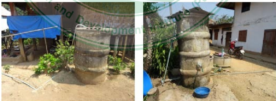
ภาพที่ 4.55 ระบบกระจายน้ำเข้าครัวเรือน
