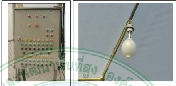
ภาพที่ 3 ระบบไฟฟ้าและแสงสว่าง ตู้ควบคุมไฟฟ้า (ขวา) หลอดไฟฟ้าให้แสงสว่าง (ซ้าย)
