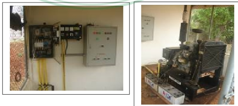
ภาพที่ 5 ระบบสำรองไฟฟ้ากรณีฉุกเฉินทำงานด้วยน้ำมันและสตาร์ทด้วยแบตเตอรี่
